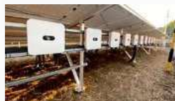
設備運転管理
