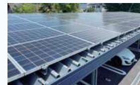
自家消費／カーポート 容量：DC99.84kWAC49.5kW
