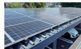
自家消費／カーポート 容量：DC99.84kWAC49.5kW
