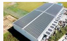
自家消費／武智発電所 容量：417.45kW
