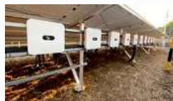
設備運転管理
